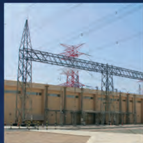
Proširenje kapaciteta elektroprenosnog sistema Katara, Katar Qatar power transmission and distribution system extension, Qatar
